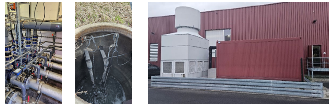
Abbildung 39: Ermittlung der Wärmemenge bei Stahl- und Drahtwerk Röslau GmbH
