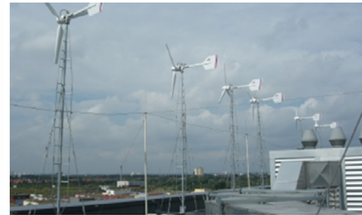
Abbildung 24: Beispiel einer Kleinwindanlagen auf Flachdach eines Bürogebäudes 11
