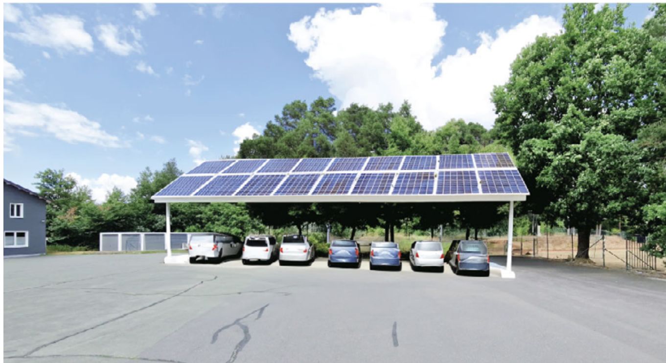
Abbildung 79: Solarcarport, Parkplatz Turnhalle
